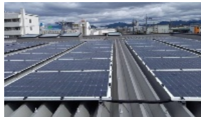
深川医療器の屋根上に設置した薄型太陽光パネル
